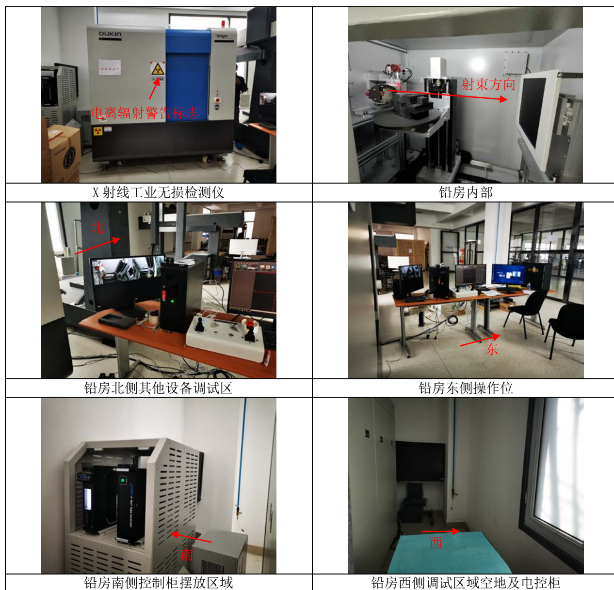
图 2-1 本次验收 X 射线工业无损检测仪现场照片
