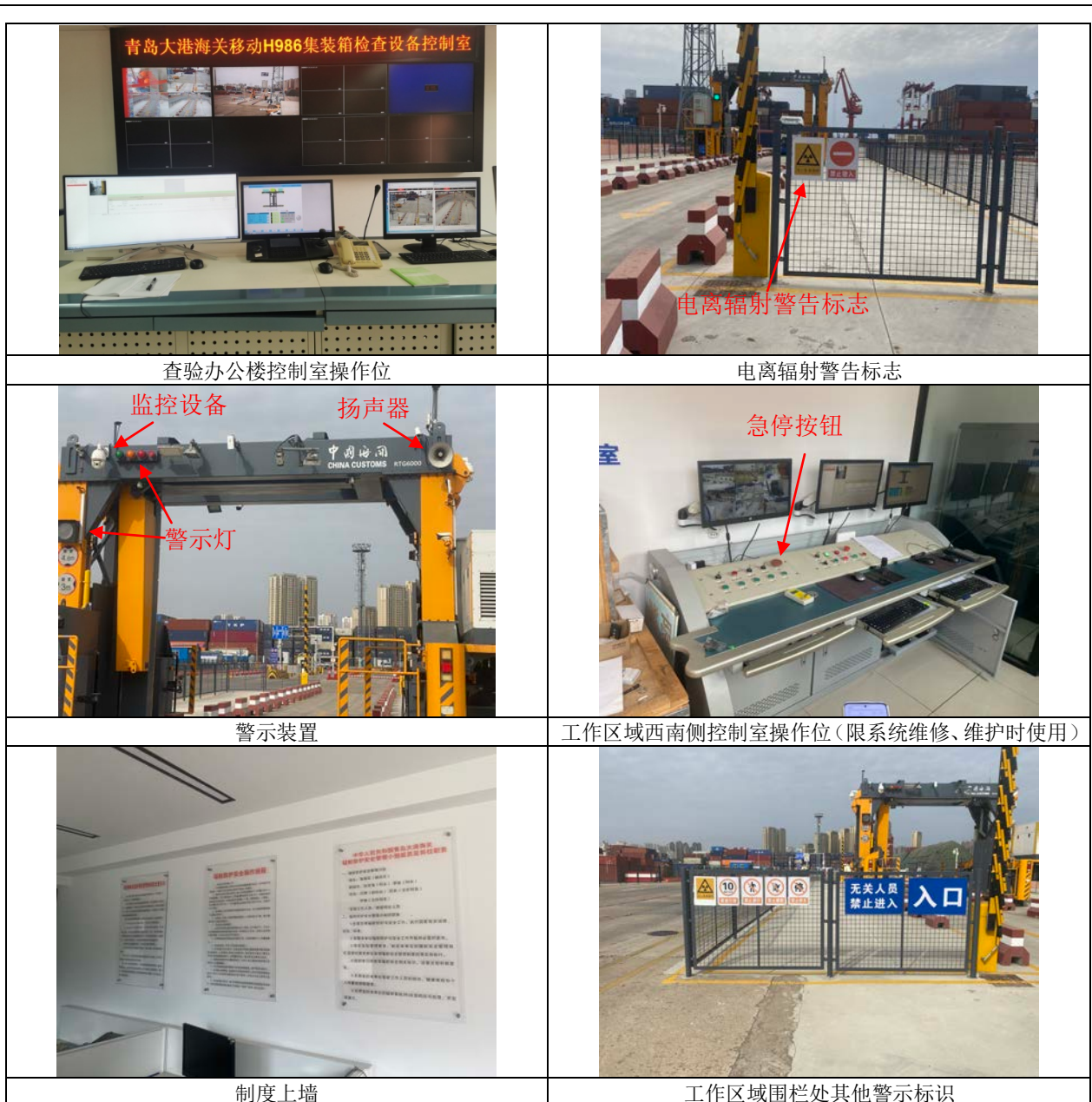
图 2-1（续） TC-SCAN RTG6000 型集装箱/车辆检查系统工作区域现场照片
